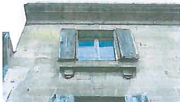
Bat A – Travée gauche. R+2. Menuiserie bois ( croisée + volets). Corniche pierre et gouttière pendante en PVC beige.
